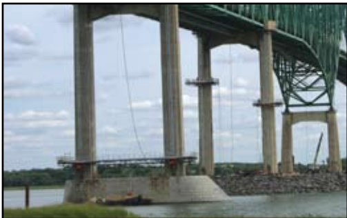
Point Lavolette, Trois-Rivières, Québec, Canada. Plus de 10 000 sacs ont été utilisés pour réparer des pièces sur les poutres du pont, à des hauteurs allant jusqu'à 60 mètres (200 pieds).
